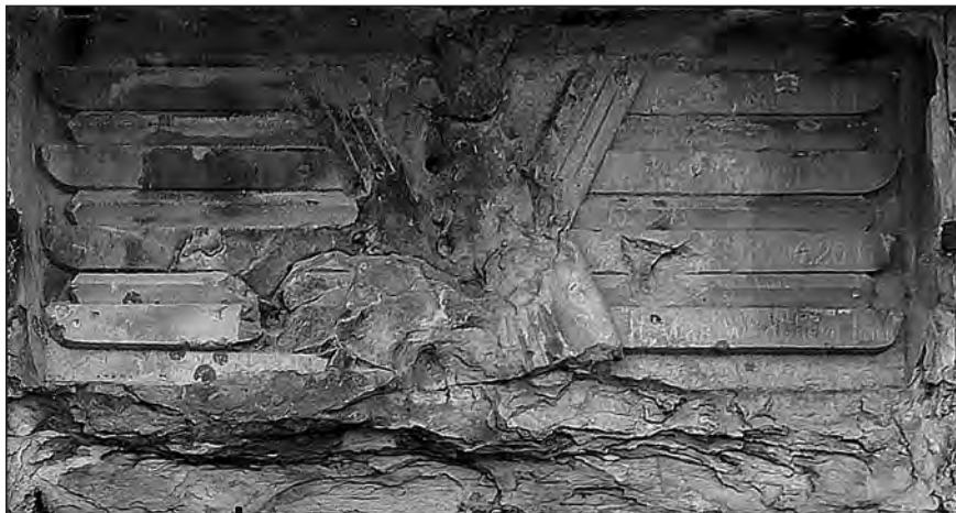
Pozostałości płaskorzeźby orła w 2011 r. (fot. A. Wielocha)
